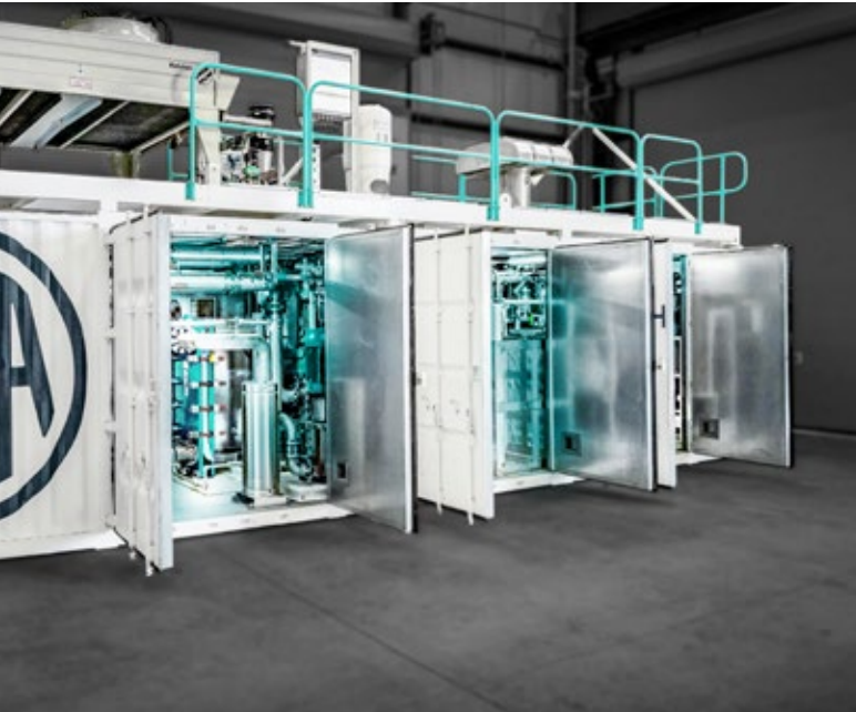
Kern des Projektes: NEA | HYTRON PEM-Elektrolyseur. © NEUMAN & ESSER
